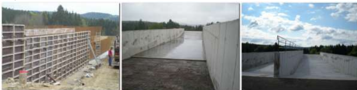
Senážní žlab byl dán do předčasného užívání 15. června 2012, takže farma mohla naskladňovat senáž
