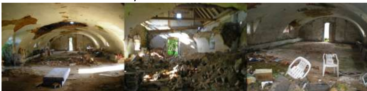
Zdevastovaný vnitřek hospodářských budov – 10.9.2016 – F.Z.
