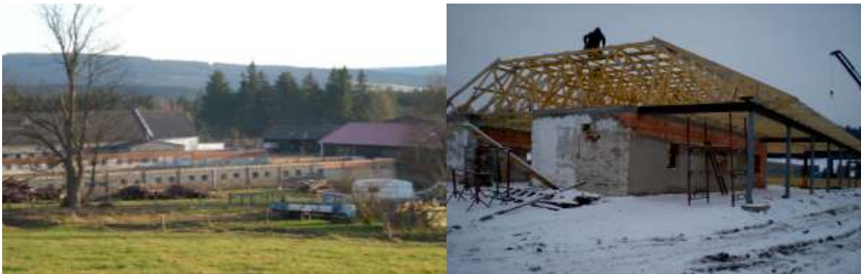
Obvodové zdi byly postaveny koncem listopadu a v polovině prosince 2009 se již montoval krov
