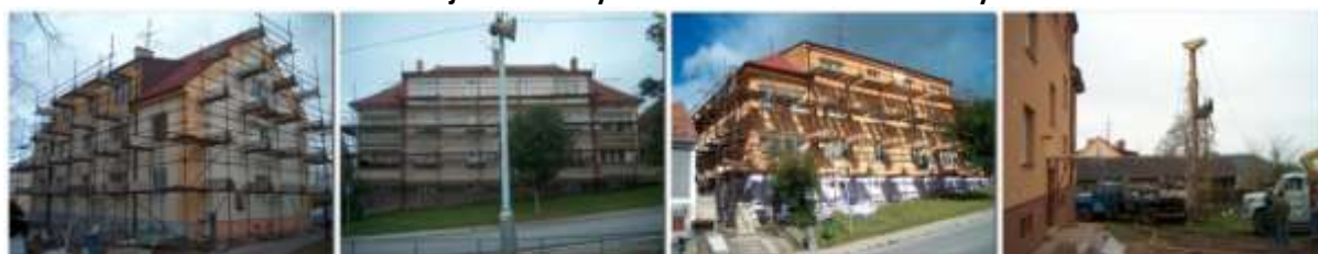
Generální oprava bytovek – č.17 bytovka 3.11.2003 + č.19 bytovka 16.7.2004 + č.19 bytovka 24.9.2004 + č.19 vrt na tepelné čerpadlo 15.10.2004
