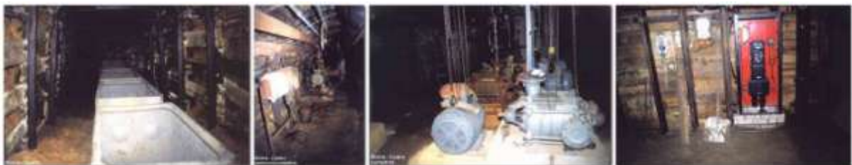
Pohled na druhé a třetí patro + pumpárna + strojovna
