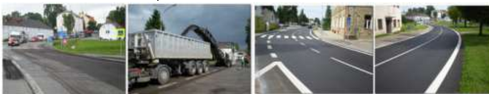
Úsek od mostu ke škole 9.8.2011 + směrem k odbočce na Jestřábí 9.8.2011 + celkový pohled 22.1.2012 – F.Z.
