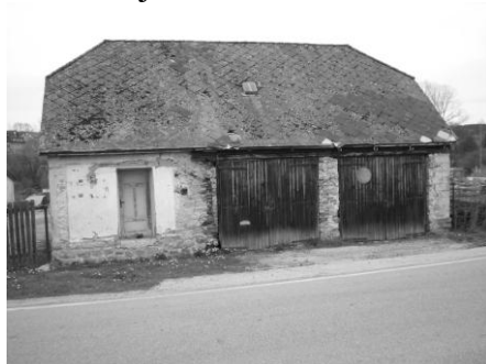
Domeček v areálu služeb bude potřebovat pořádnou opravu
